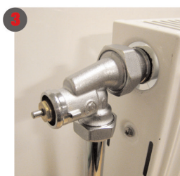
Vous apercevez maintenant le mécanisme à changer
