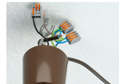
Connexion des luminaires avec câble flexible
